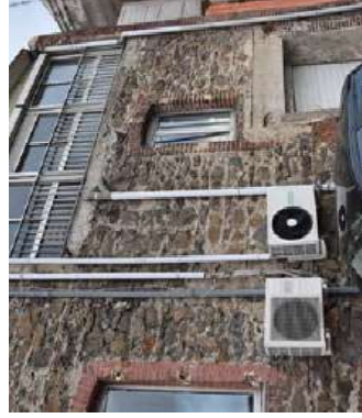
Réseaux de climatisation envahissant la façade
